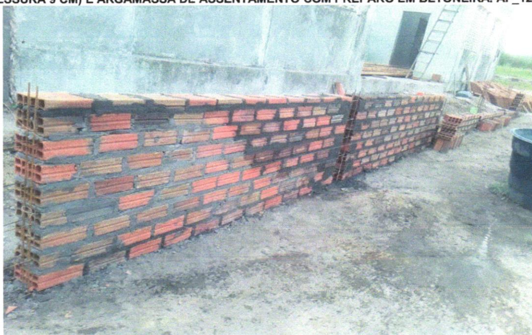
Foto 06- ALVENARIA DE VEDAÇÃO DE BLOCOS CERÂMICOS FURADOS NA HORIZONTAL DE 9X19X29 CM (ESPESSURA 9 CM) E ARGAMASSA DE ASSENTAMENTO COM PREPARO EM BETONEIRA. AF_12/2021
