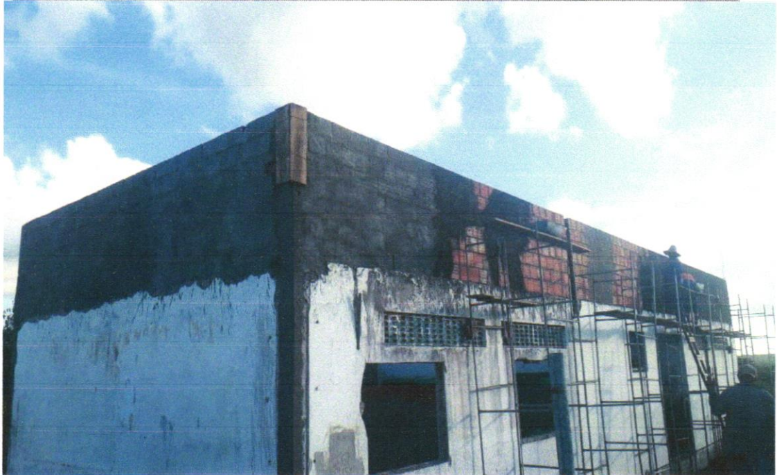
Foto 13- CHAPISCO APLICADO EM ALVENARIA (COM PRESENÇA DE VÃOS) E ESTRUTURAS DE CONCRETO DE FACHADA, COM EQUIPAMENTO DE PROJEÇÃO. ARGAMASSA TRAÇO 1:3 COM PREPARO EM BETONEIRA 400 L. AF_06/2014
